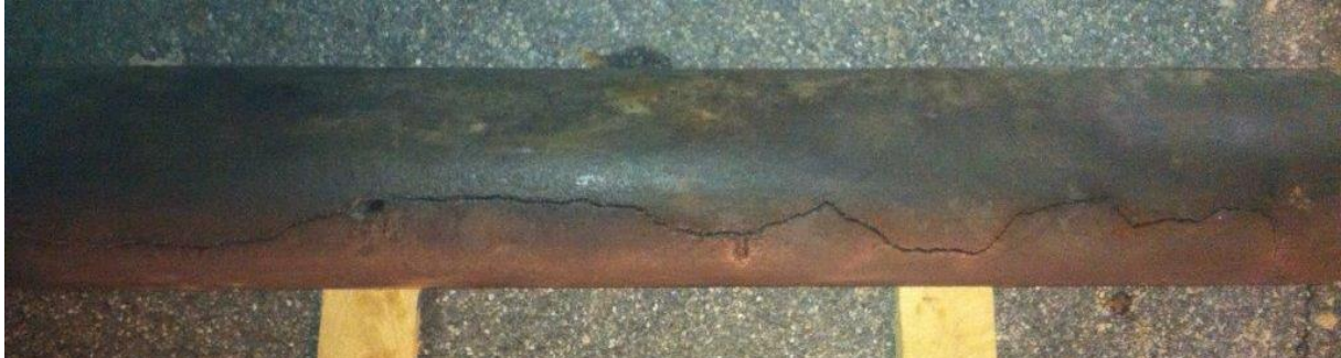
Müssen saniert werden: Die Graugussleitungen in Bolligen sind zum Teil über 80 Jahre alt.
